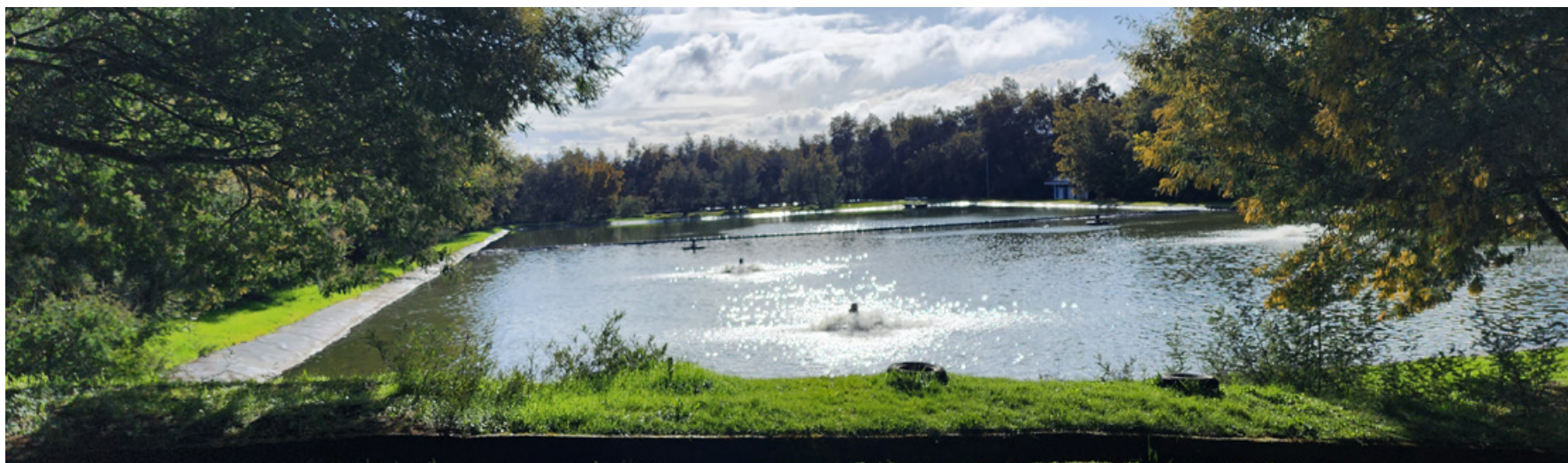
Planta de Tratamiento de Aguas Servidas (PTAS), Mininco.
