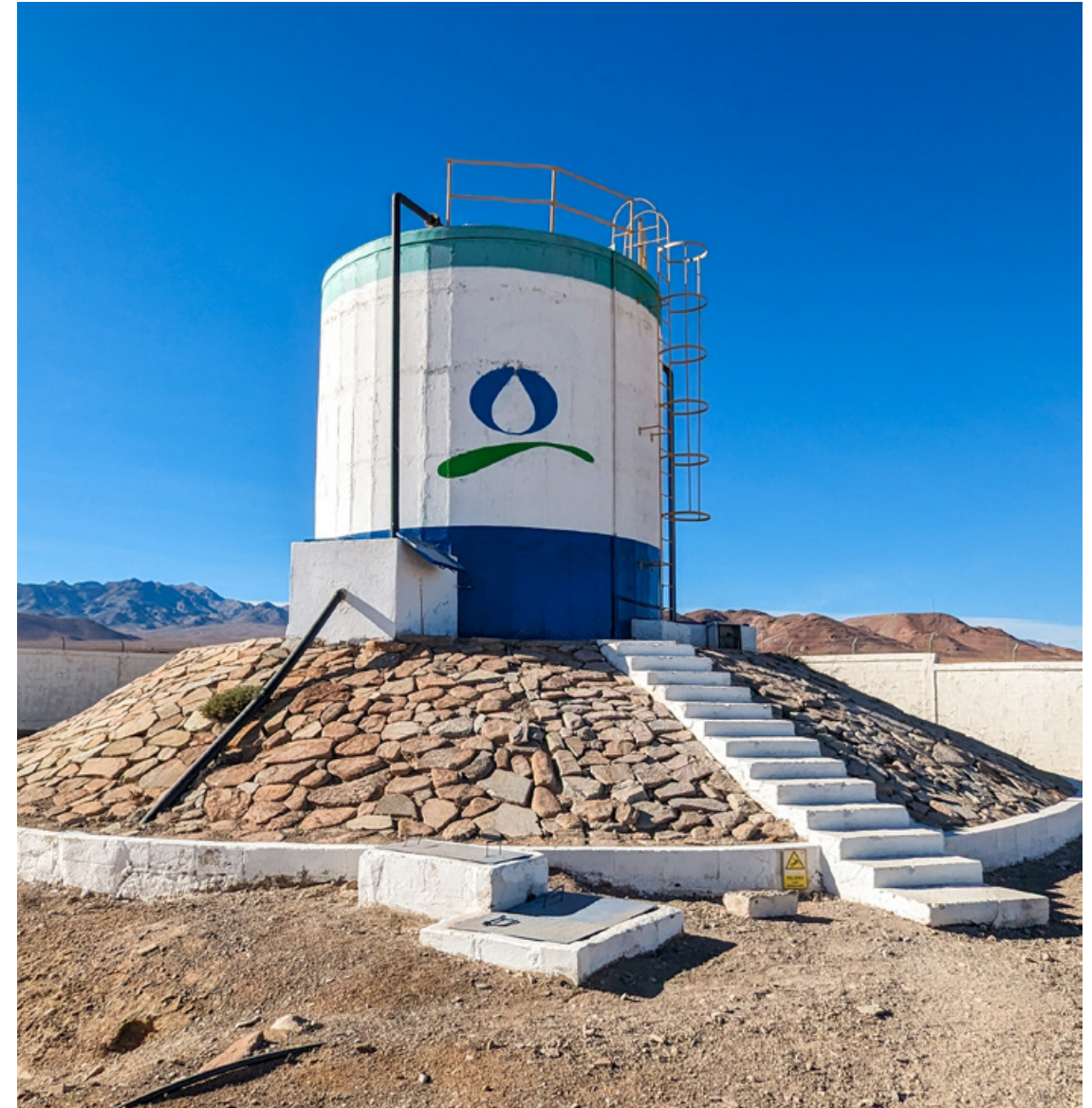
Planta de Tratamiento de Agua Potable (PTAP), Inca de Oro.
