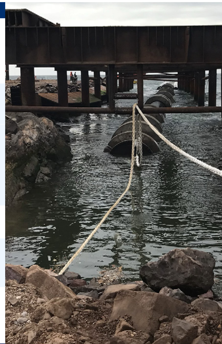
Descarga de emergencia, Antofagasta.
