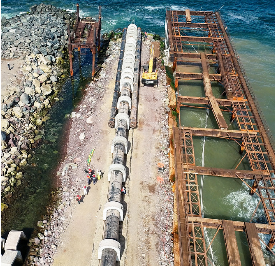
Descarga de emergencia, Antofagasta.
