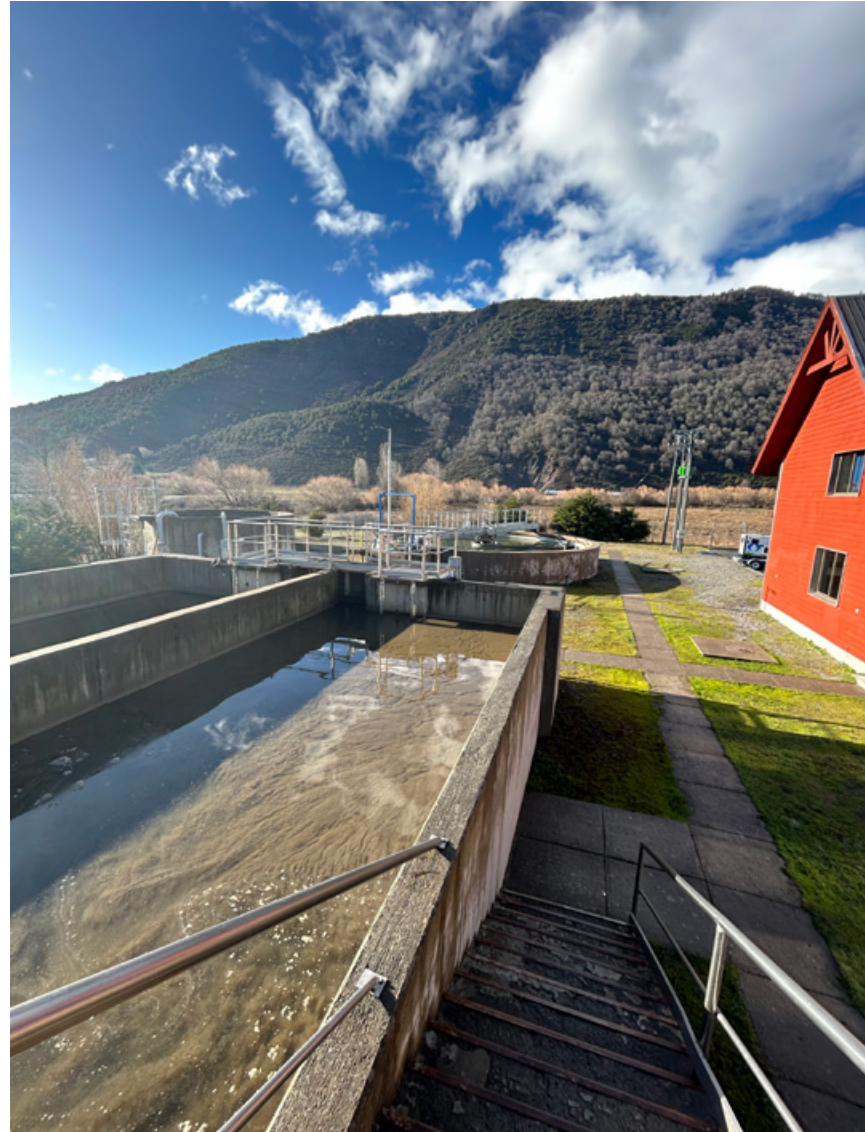
Planta Tratamiento de Aguas Servidas (PTAS), Lonquimay.
