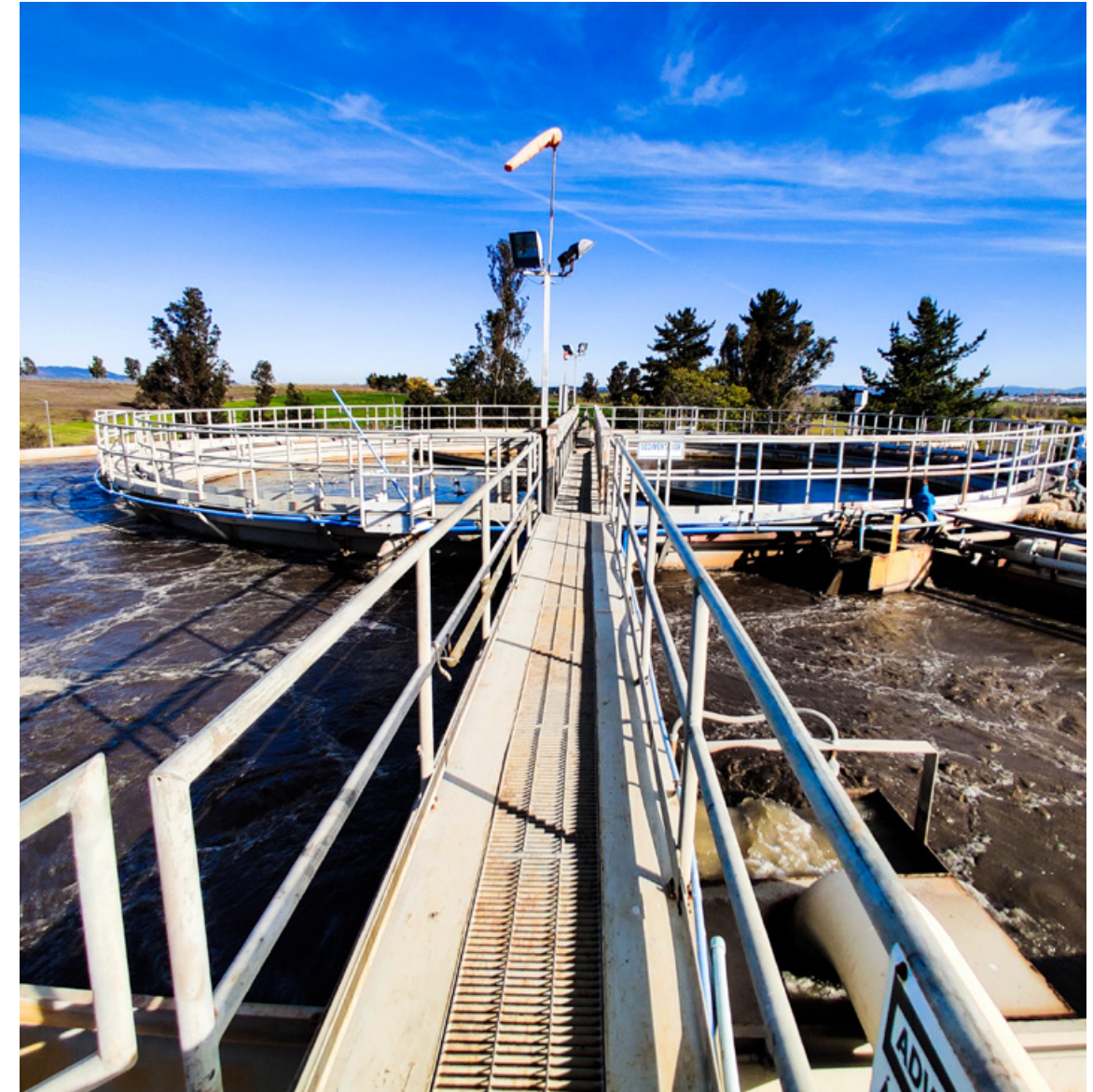
Planta de Tratamiento de Aguas Servidas (PTAS), Cauquenes.
