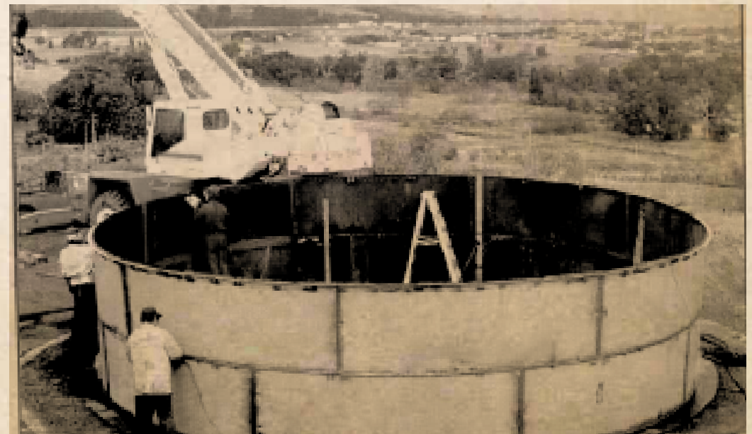
Construcción de estanque de agua potable de 100 m 3 en Cerro Puna Pau
