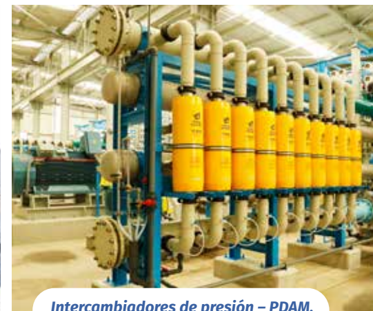
Intercambiadores de presión – PDAM.
