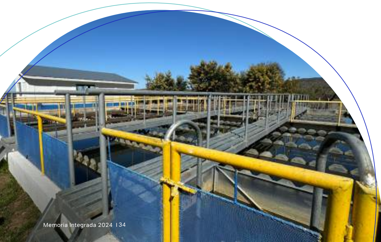
Planta de tratamiento de agua potable (PTAP), Angol.
